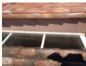
Figure 9 – A gauche, le manque de place pour les eaux d'écoulement. A droite, le simple joint silicone sans recouvrement
