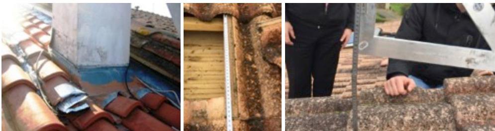
Figure 8 – D'autres défauts d'exécution évidents
