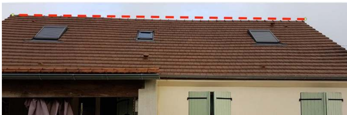
Figure 21 – Affaissement de toiture après aménagement de combles
