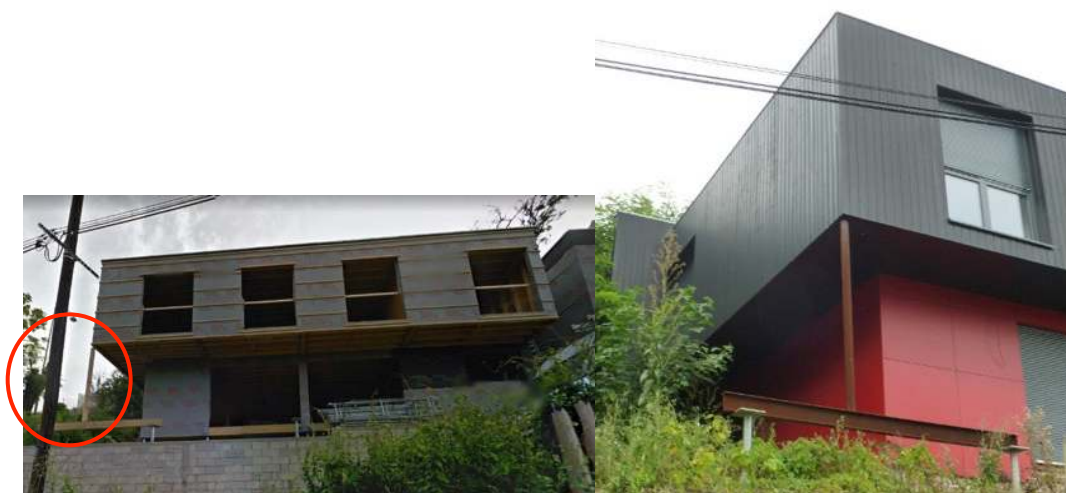
Figure 21 – Des étaielements provisoires ... qui auraient pu se transformer en poteau définitif
