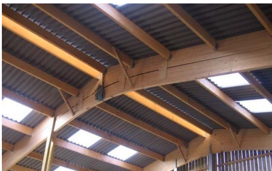
Figure 20 – Rupture liée à la surestimation de la résistance du bois
