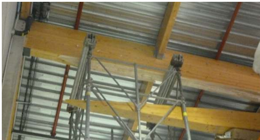
Figure 19 – décohésion des fibres de bois sur un arbalétrier
