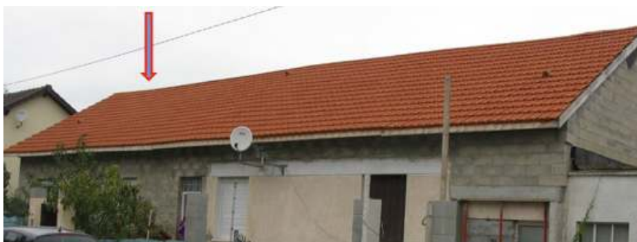
Figure 15 - Faîtage déformé par une charpente sous-dimensionnée
