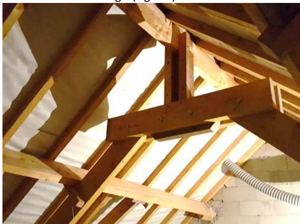
Figure 16 - Arbalétrier dont les montants sont trop courts
