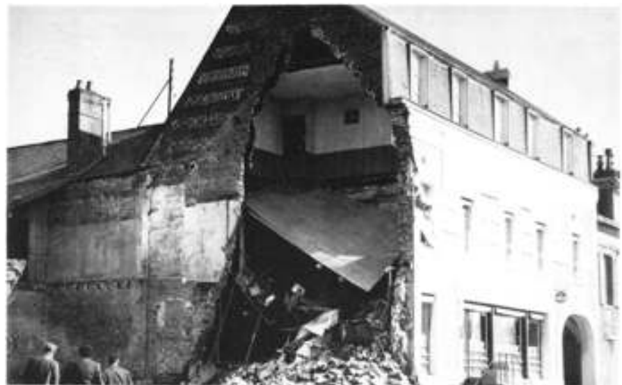
Fig.44 et 45- Affouillement le long du pignon: le sol puis le pignon s'effondrent
