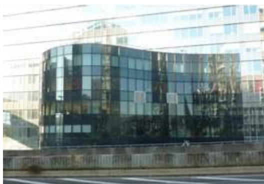
Figure 16 – Chute de panneaux de verre
