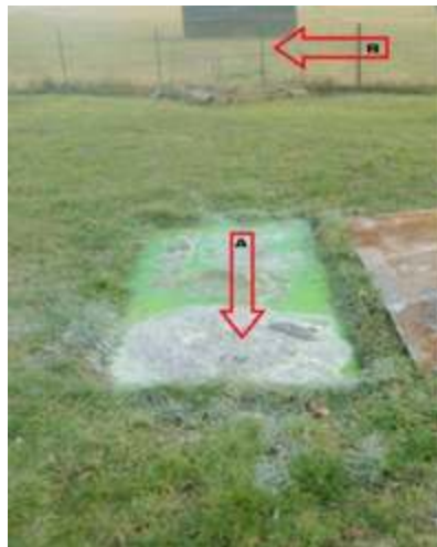
Figure 1 – Débordement au niveau de la fosse septique (A) et résurgences (B)
