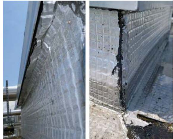
Figure 8 — Retournement du relevé occasionnant des passages d'eau en arrière
