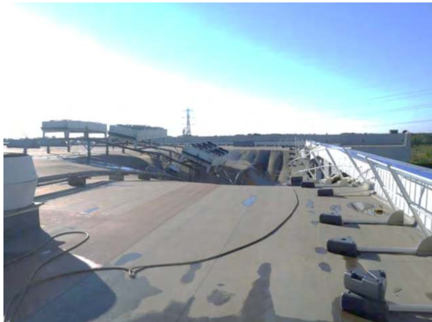
Figure 10 — L'absence de pente conduit à l'effondrement des toitures TAN ou bois
