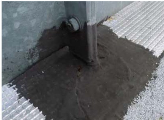
Figure 9 — Mauvaise mise en œuvre de la résine d'étanchéité
