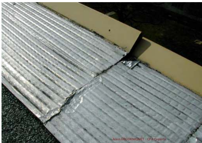
Figure 7 — Déchirure de la bande d'étanchéité sur rive en acier
