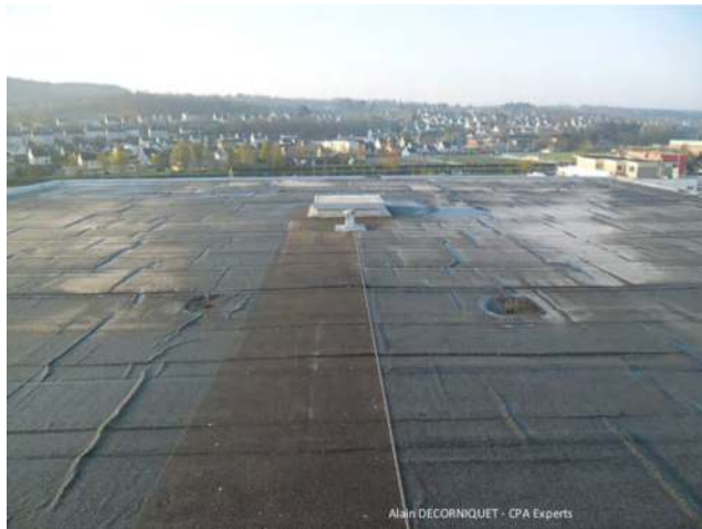
Figure 5— Reptation et plissement de l'étanchéité
