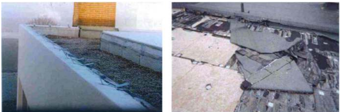
Figure 1 — À gauche arrachage d'une couverture, à droite envol d'un revêtement d'étanchéité
