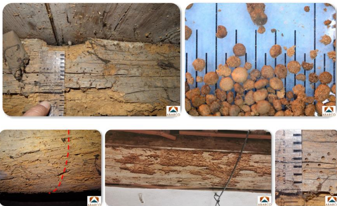
Figure 5 — Dégradations du bois par les ILX
